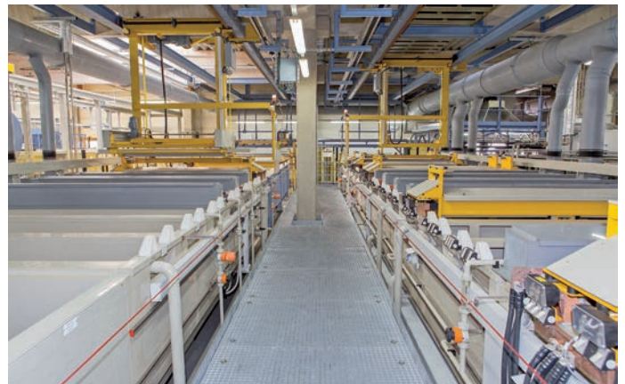
Blick über die Anlage
