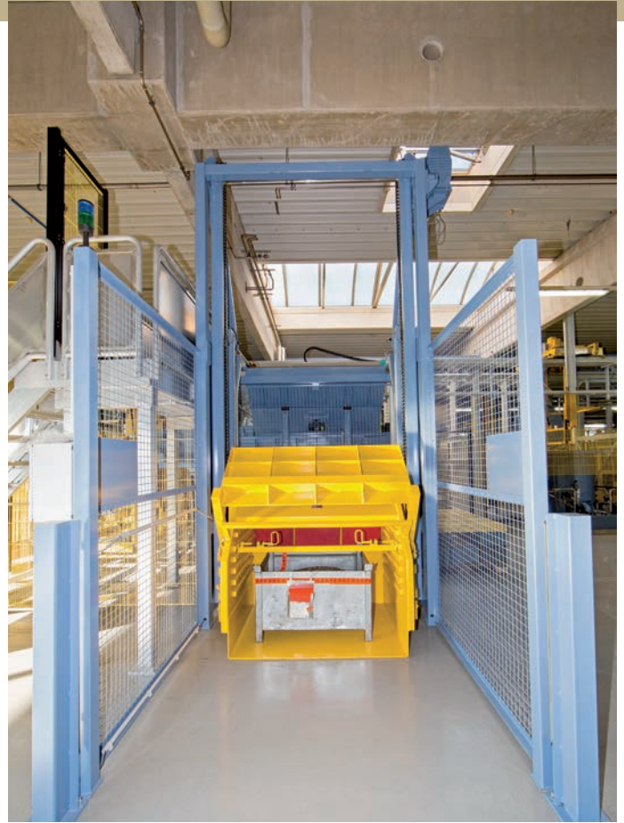
Beladebunker der Vorchargierungsanlage
