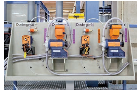
Dosierung für den Zink-Nickel-Elektrolyten
