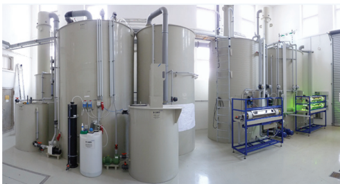
Abb. 2: Abwasseranlage der Fa. Schlötter. Von links nach rechts: Abluftanlage, Füllungsbehälter, Schlammeindicker, UV-Behandlung 1, UV-Behandlung 2
