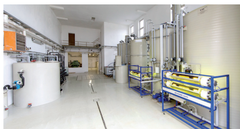
Abb. 6: Abwasseranlage, im Vordergrund die beiden UV-Oxidationsreaktoren
