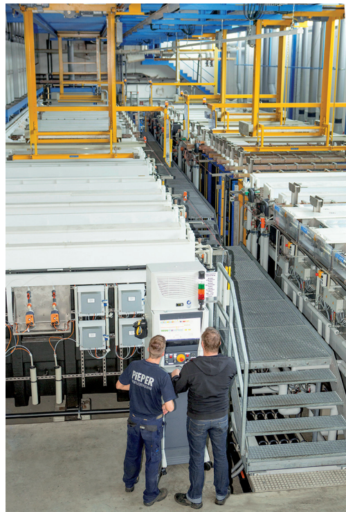
Abb. 1: Blick auf die zweistraßige ZnNi-Anlage
